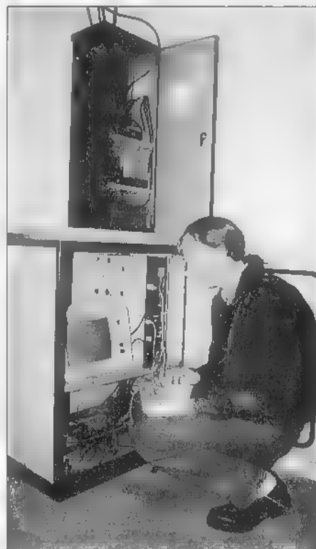
Sysop Hans Roovers (PE1GCJ) bij de opstelling van PI8DRE, de node-locatie op het ziekenhuis in Hoogeveen. In de bovenste kast bevinden zich de zendantvangers, daaronder staat de besturings PC opgesteld.
